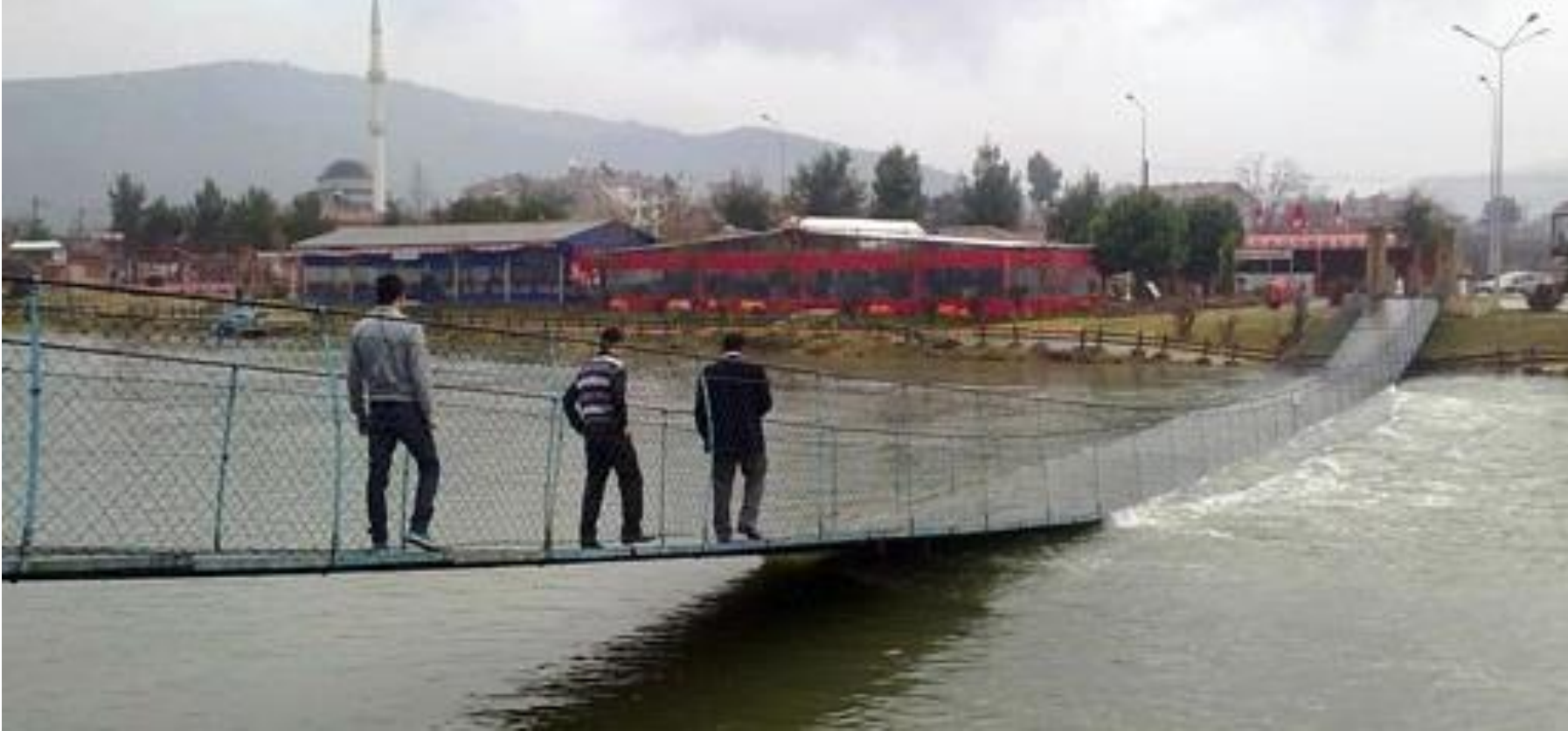
Yüklere dayanabilmiş ancak aşırı şekil değiştirmekle işlevselliğini yitirmiş bir köprü
